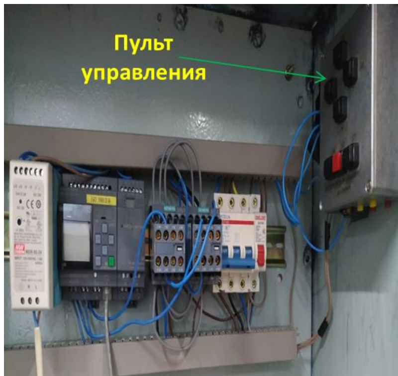
Рисунок 8 – Электрический щит с Logo- модулем Слева направо: инвертор, модуль Logo, расширяющий модуль Logo, 2 магнитных пускателя по порядку, автоматический выключатель для 3- фазного тока, автоматический выключатель для питания розеток, пульт управления
